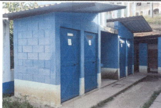
Foto 4: Pintura en muros exteriores area de baños
